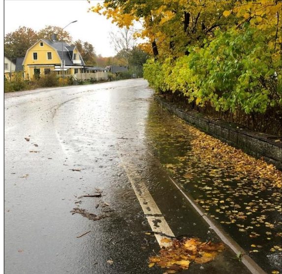
Vattenansamling på Landsvägen.
