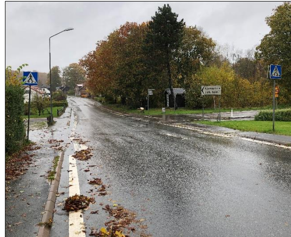
Sliten vägmålning på övergångsstället i höjd med Frostavägen.
